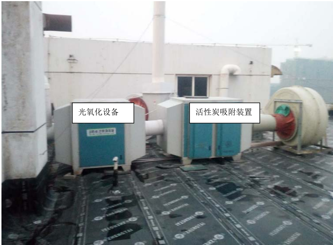
图 3-2 (b) 废气处理措施（光氧化设备+活性炭装置）
