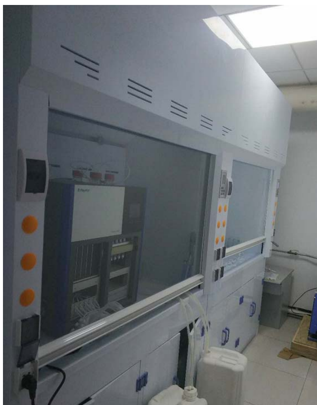
图 3-2 (a) 废气收集设施（通风橱）
