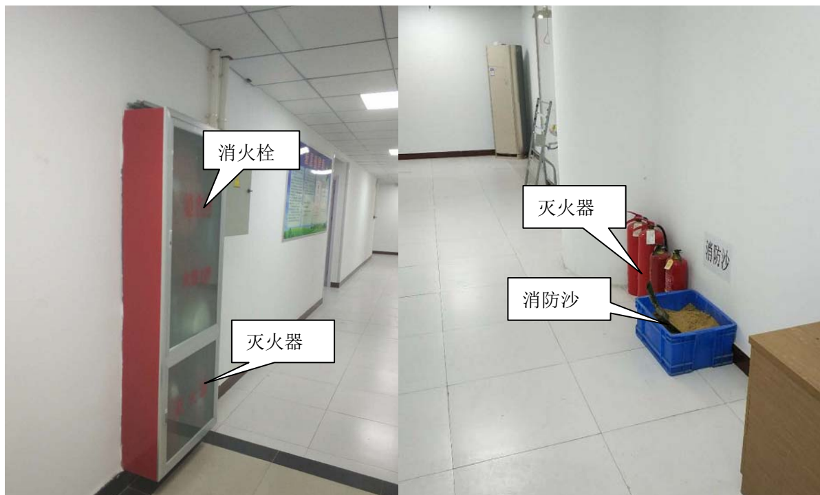
图 8-1 消防设施设置情况
